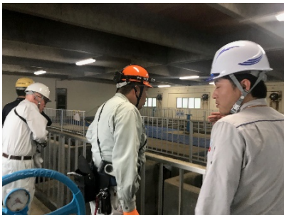
浄水場メンテナンス
